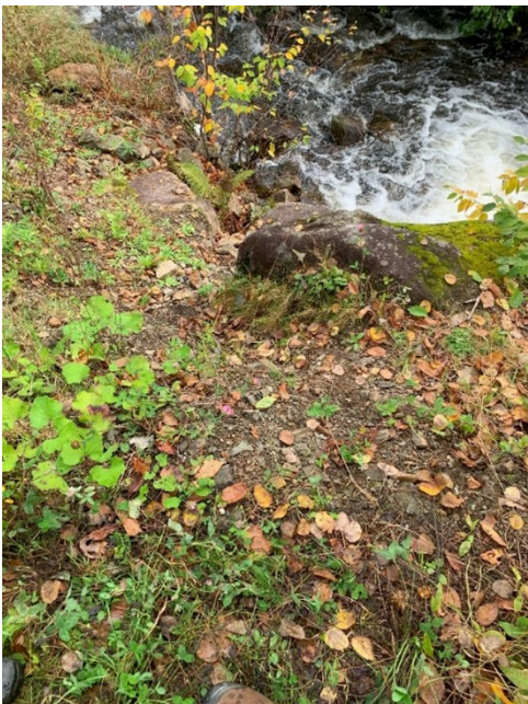
Figure 4-4 : Érosion du côté gauche, à l'aval de la structure
