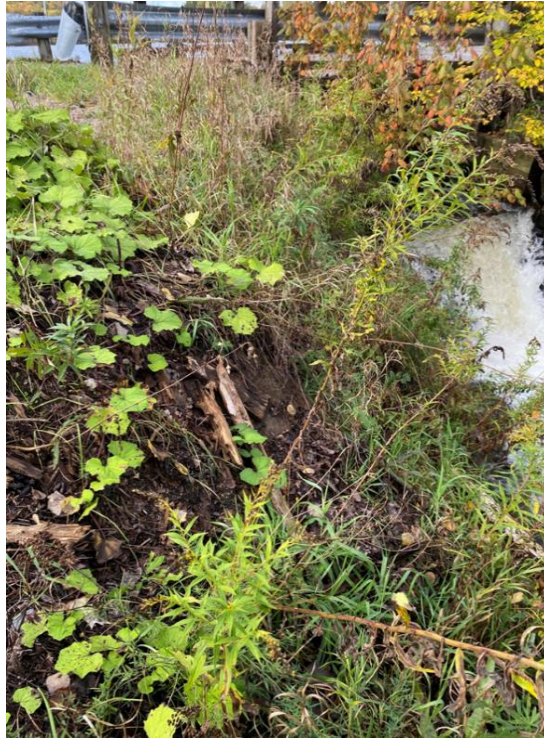
Figure 4 : État des pentes du talus aval à la rive droite, signes d'érosion superficielle sans glissement majeur.
