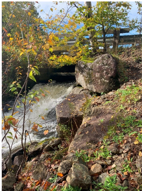
Figure 4-5 : Érosion du côté gauche, à l'aval de la structure vue de face
