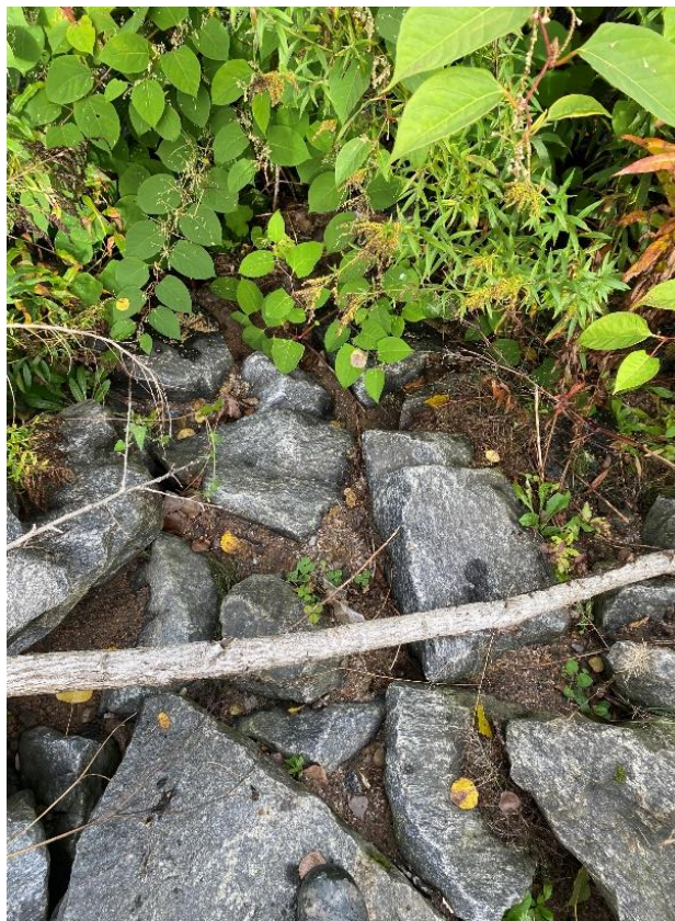
Figure 3 : Sol mouillé observé à la base du talus aval sans exfiltration d'eau notable à proximité du déversoir.
