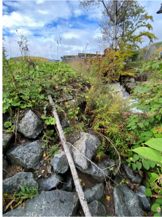
Figure 6 : Revêtement du talus en aval avec empierrements. Absence de couverture similaire sur la rive gauche.
